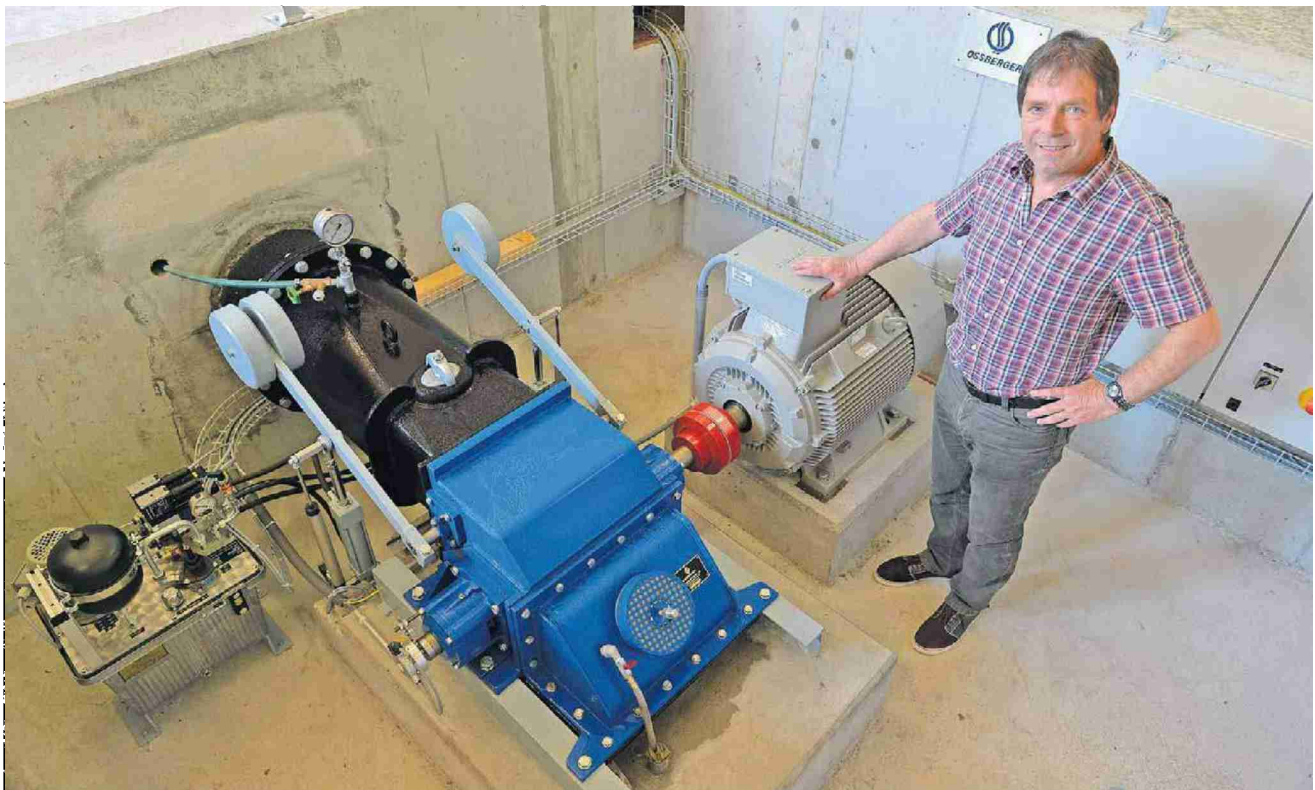
Bild oben: Armin Meier zeigt sein Kleinkraftwerk, links das Steuermodul, blau die Turbine, rechts der Generator. Bild links: Ein Blick in den Wasserkanal.
